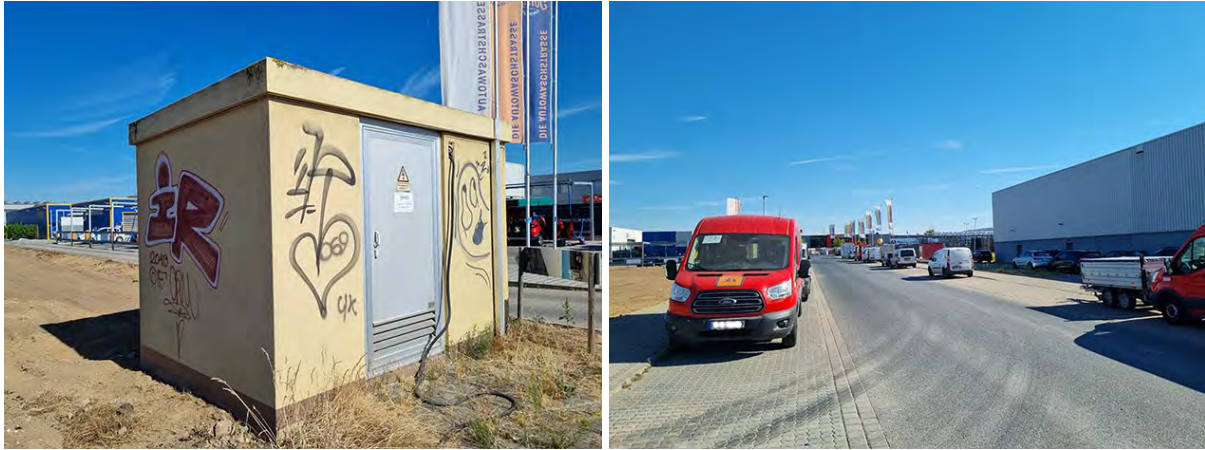
Abbildung 8: Bestehende Transformatorstation innerhalb des Plangebietes (links), Straßenverkehrsfläche der Zeppelinstraße (rechts) (Bestandsaufnahme am 02.08.2022) (Quelle: Planergruppe ROB GmbH, Schwalbach am Taunus)
